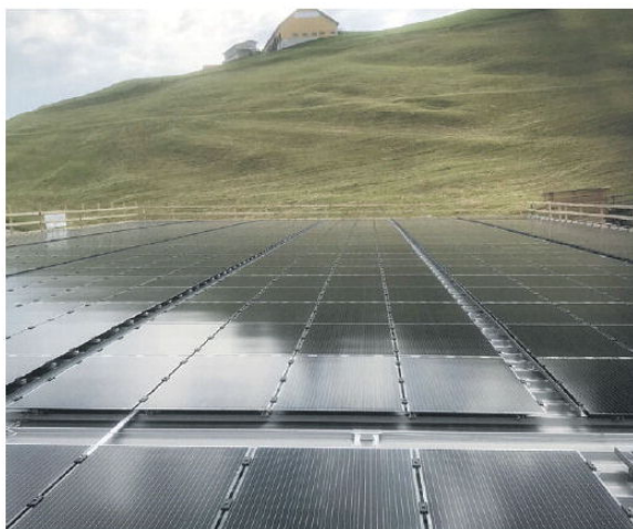
Die im Juni 2020 in Betrieb genommene Photovoltaik-Anlage Reithalle Kloster ist das zweite realisierte Projekt der Genossenschaft G3E.
